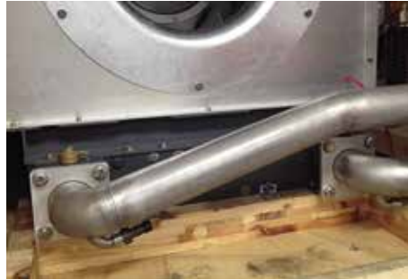
Festrohrende der Schlauchleitungen am Kühler.
