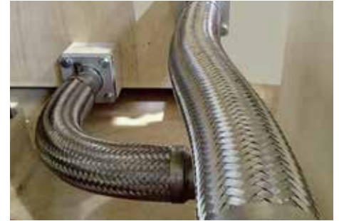
Flexibler Schlauchteil Vor-/Rücklauf Anschluss Trafo-seitig.
