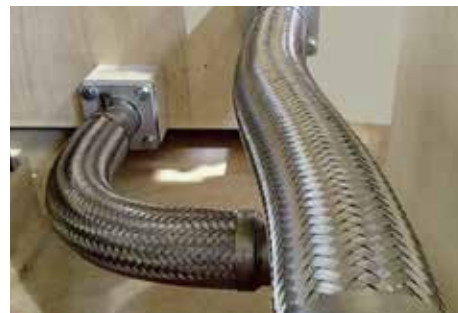
Sezioni flessibili giuntate al trasformatore.
